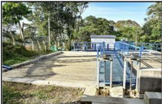
Figura 28. Floculación PTAP, Autor, 2022.
