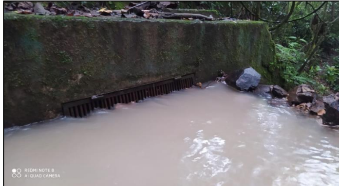
Figura 22. Captación lateral Quebrada El Garruchal, Autor, 2022.
