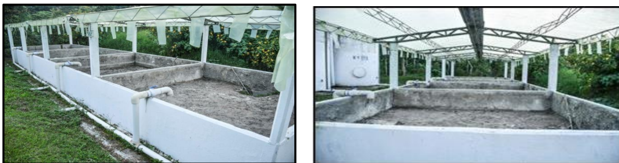
Figura 41. Lechos de secado PTAR, Autor, 2022.
