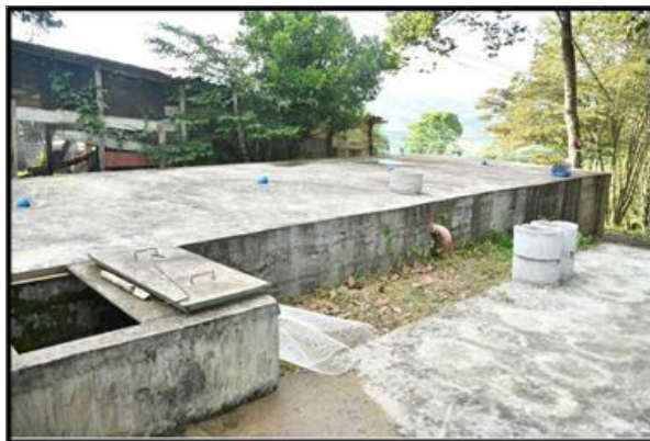
Figura 33. Tanque de almacenamiento 1 y 2, Autor, 2022.
