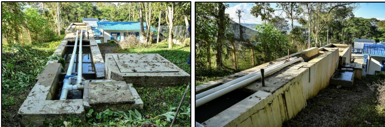
Figura 24. Desarenador PTAP, Autor, 2022.
