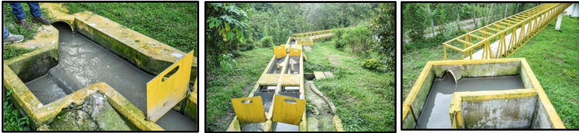
Figura 38. Canal de entrada, rejilla, desarenadores y canaleta parshall, Autor, 2022.
