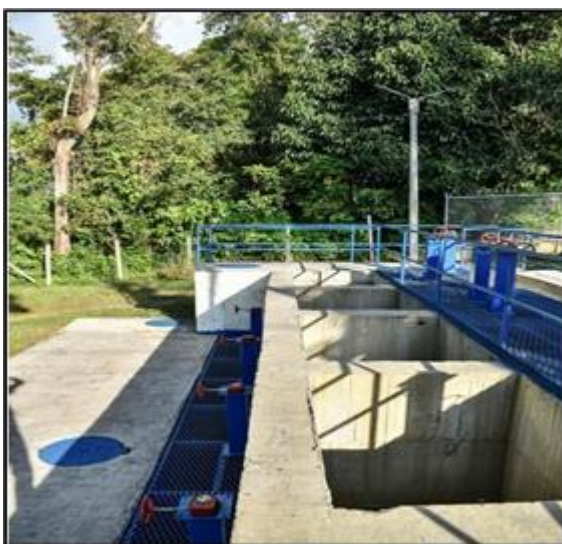
Figura 31. Filtración PTAP, Autor, 2022.
