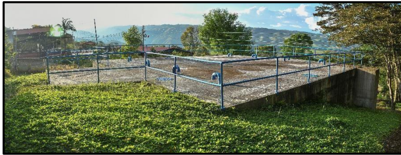
Figura 34. Tanque de almacenamiento 3, Autor, 2022.
